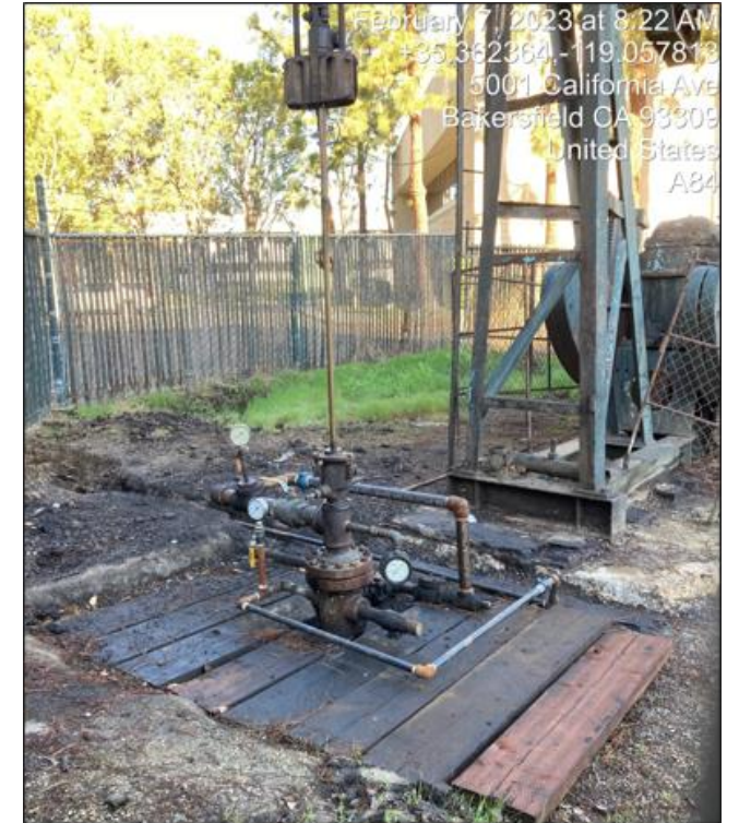
Well that leaked gas in Bakersfield (Summer 2022)/ Pozo que tenía gas en Bakersfield (verano de 2022)
